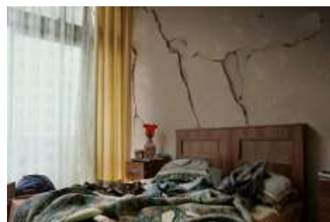
تصویر ۲. ترک دیوار اتاق خواب بعد از تخریب ساختمان
